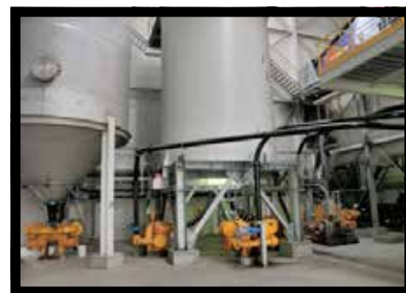
Cuves de maturation et de déshydratation
