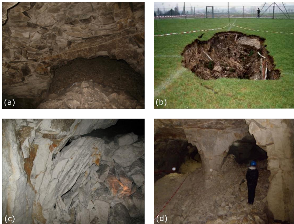
Figure 8 : Quelques dégradations fréquemment rencontrées dans les carrières souterraines (source : Dubois, 2019). (a) Chute de toit. (b) Fontis. (c) Desquamation d'un pilier à Lezennes. (d) Pilier en diabolo à Lille-Hellemmes.
