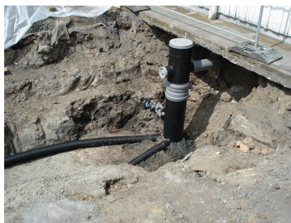
FIGURE 5.2 – Sortie du puits canadien
