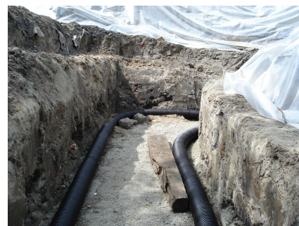
FIGURE 5.3 – Tuyaux composant le puits canadien
