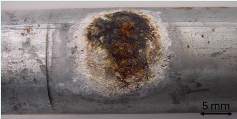
Photo 1 : Fuite apparue dans une installation sanitaire d'eau froide dans un tuyau en acier galvanisé
